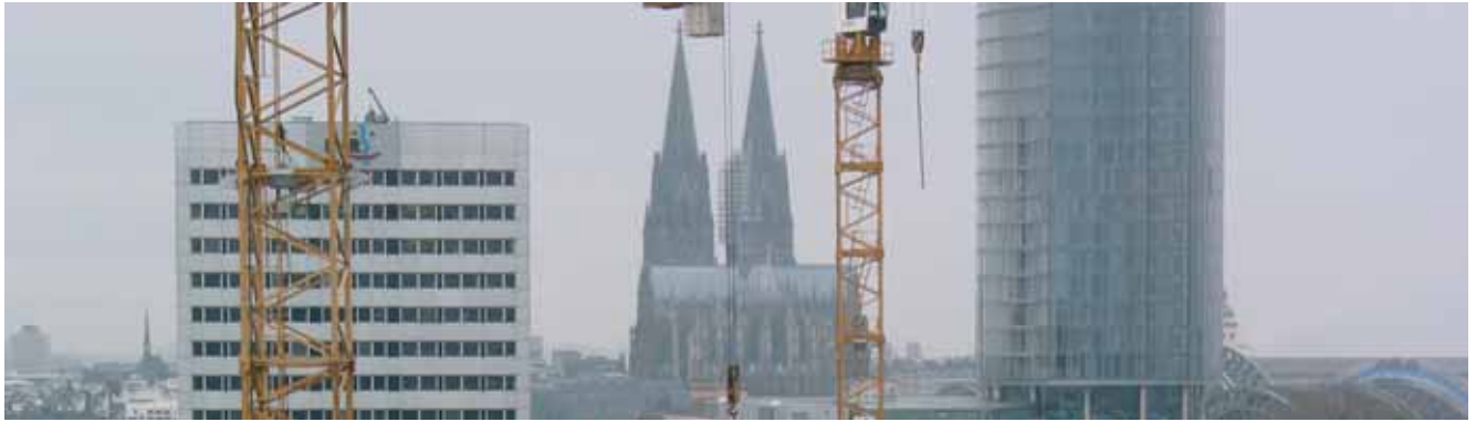
Oben: Blick über die im Bau befindlichen Constantinhöfe nach Westen auf die andere Rheinseite.
